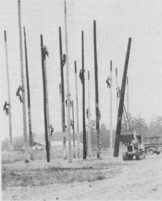
A la régionale Louis-Frêchette, à Lévis, ce ne sont pas les poteaux qui manquent! Le cours "monteur de lignes" permet d'apprendre à grimper, à ériger un pylône ou à installer des conducteurs et des isolateurs. (Photo CSR-Louis-Frêchette)
