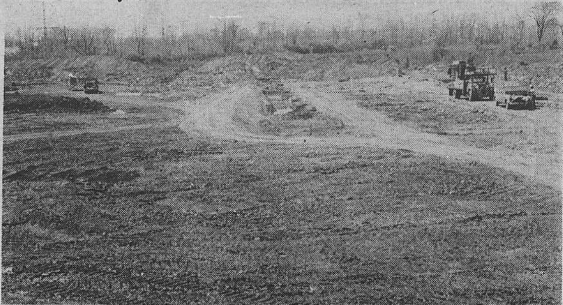
La première phase des travaux de construction de l'IGM est amorcée. On prévoit que les travaux d'excavation et de bétonnage seront terminés le 19 août prochain.
