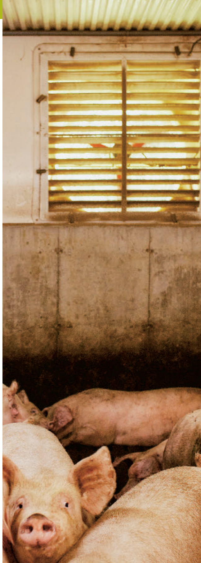
Des ventilateurs de 14 pouces ont été installés dans 3 de leur 4 engraissements ventilés conventionnellement. Le quatrième engraissement est en ventilation naturelle avec 4 pieds d'ouverture de chaque côté pour apporter un meilleur volume d'air.
