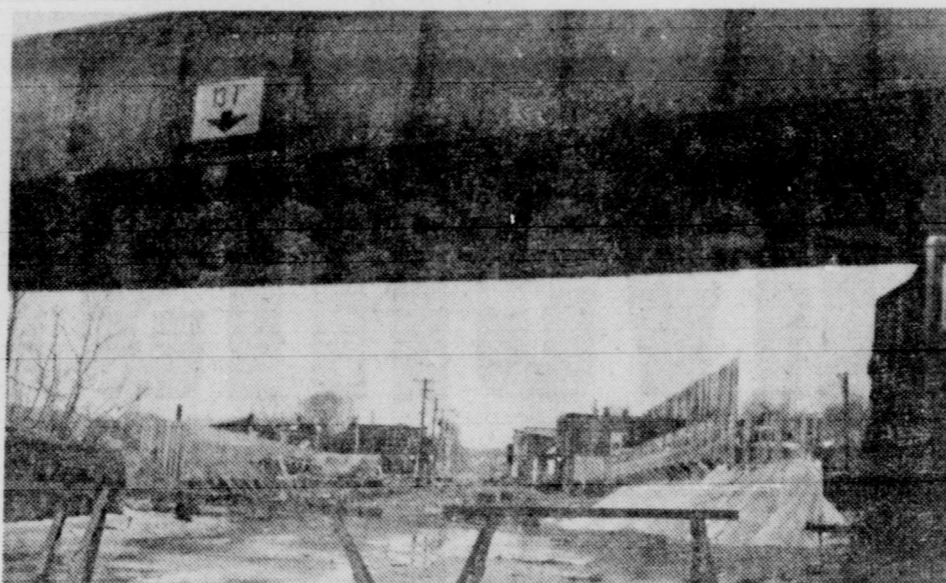
Bientôt au-dessus de la rue Sainte-Marguerite s'éleva un autre viaduc de la voie rapide intermunicipale.
