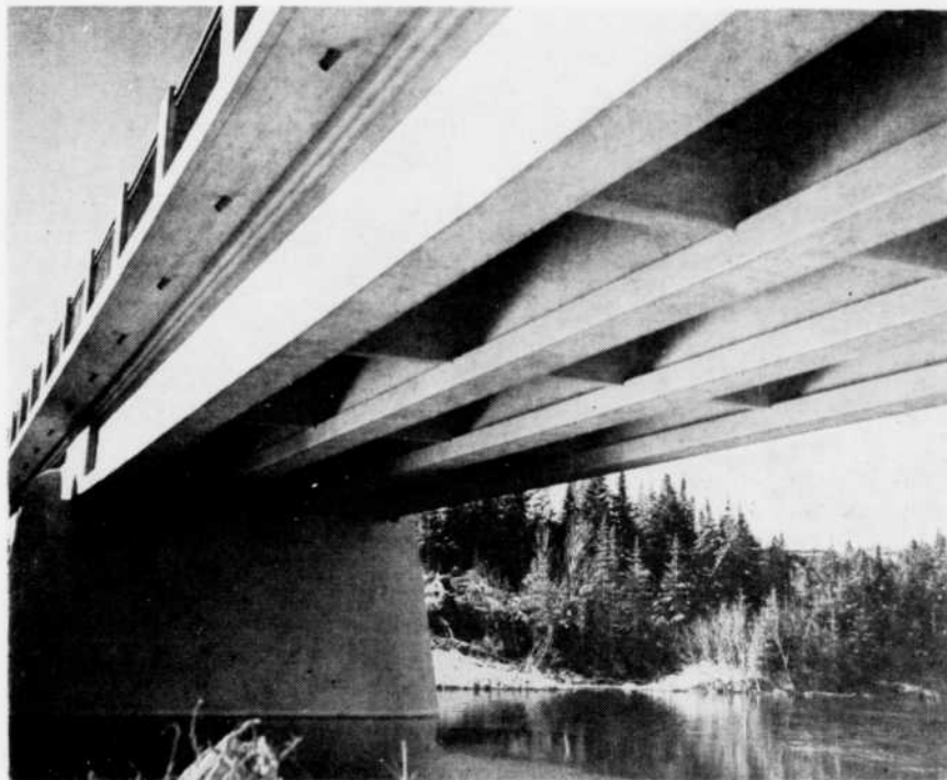
Fig. 9 — Pont sur la rivière Riverin, Comté de Saguenay. Vue du dessous de la travée montrant les poutres profilées et les entretoises.
