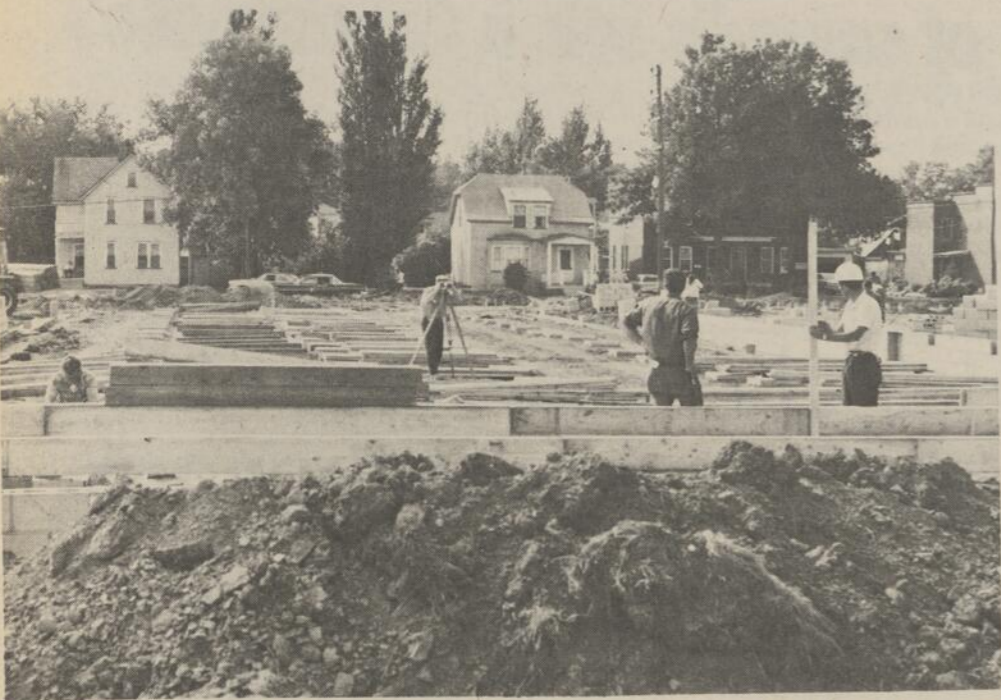
La construction de quelque 20 classes préfabriquées à l'arrière de l'École de métiers de Saint-Jean progresse normalement. L'entrée principale de cette école temporaire sera située sur le boulevard Gouin. La Commission scolaire régionale Honoré-Mercier a dû recourir à la construction de locaux préfabriqués en attendant de posséder son propre campus scolaire. Cette construction temporaire de locaux préfabriqués coûtera quelque $282,000. C'est la firme Désourdy et Frères, de Saint-Luc, qui a obtenu le contrat.
