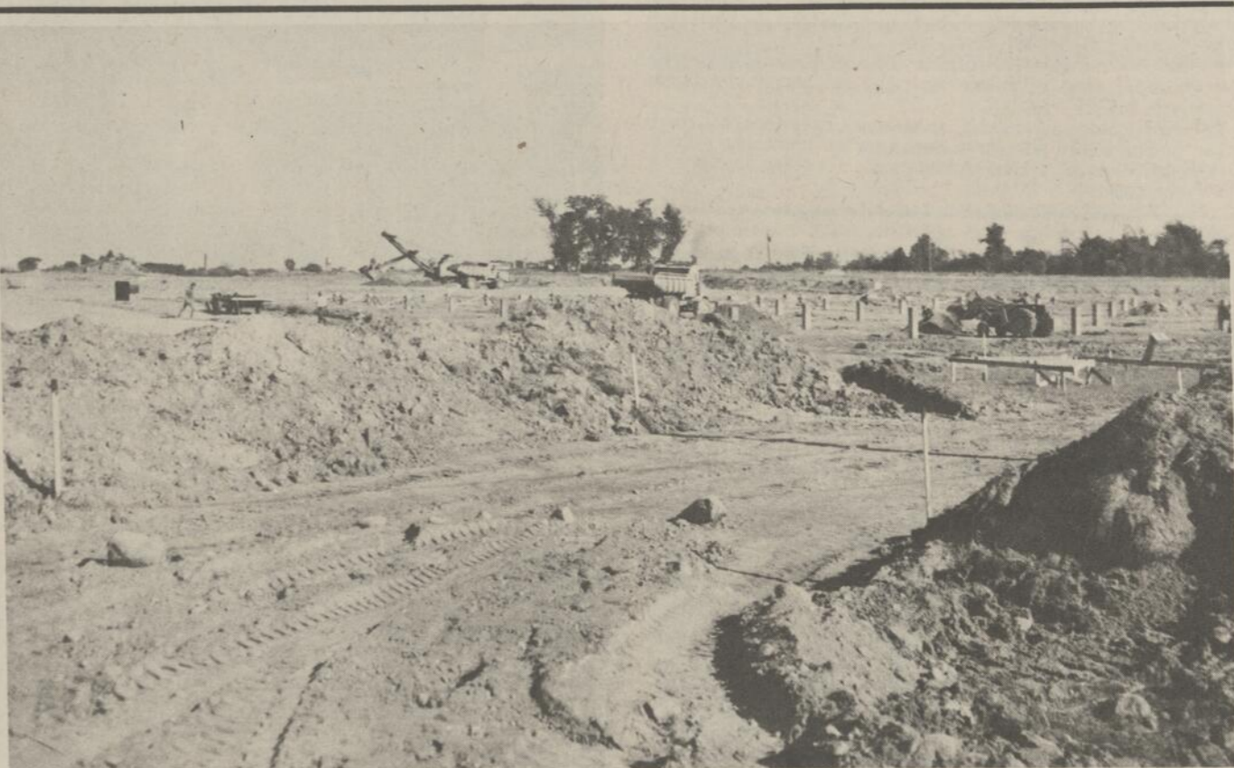
NOUVELLE USINE-- Dans quelques mois, la cité de Saint-Jean possédera une nouvelle usine de l'ordre de $3,000,000 dans son nouveau parc industriel. En effet, la compagnie Ozite Corporation a décidé de construire un nouvel édifice
