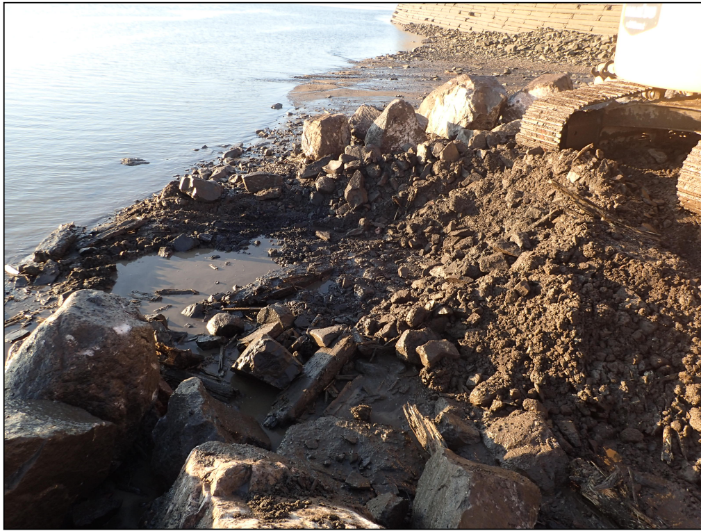
Figure 26. Arrachement de la poursuite de l'assemblage 11A200, vers le sud-ouest (photo ARTE4PB080157).
