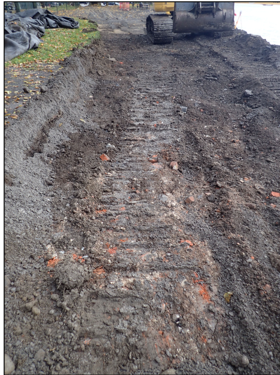
Figure 16. Concentration de débris de démolition au sommet du talus, vers le nord-est (photo ARTE6-PA270020).
