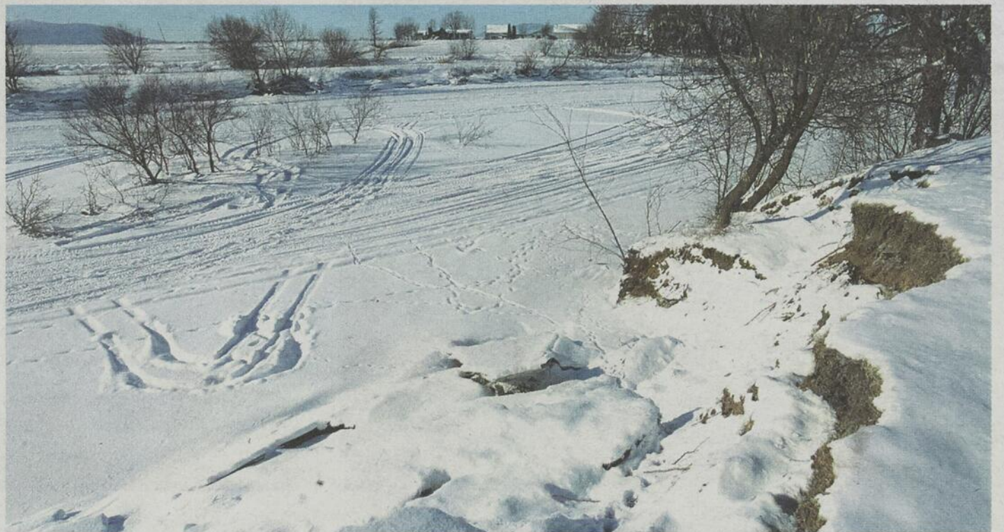
Dans la nuit du 4 au 5 décembre, une portion de la berge que longe le rang Bas-de-la-Rivière s'est affaissée dans l'eau de la rivière Noire. Photo Patrick Roger | Le Courrier ©
