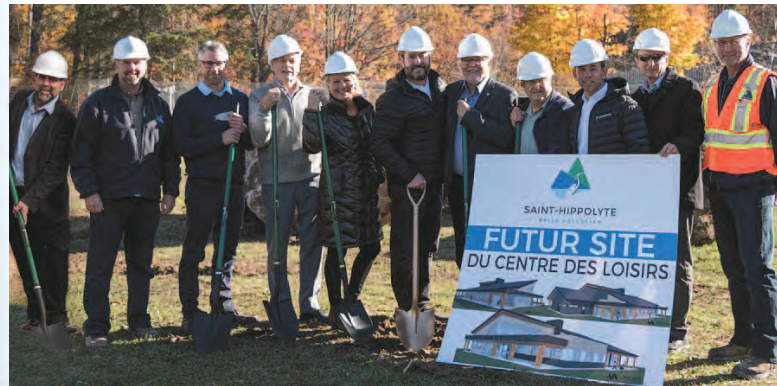
2) 20 octobre • Première pelletée de terre marquant le début des travaux de construction d'un nouveau centre de loisirs à Saint-Hippolyte.
