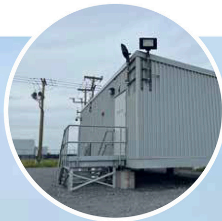
Centre de contrôle
