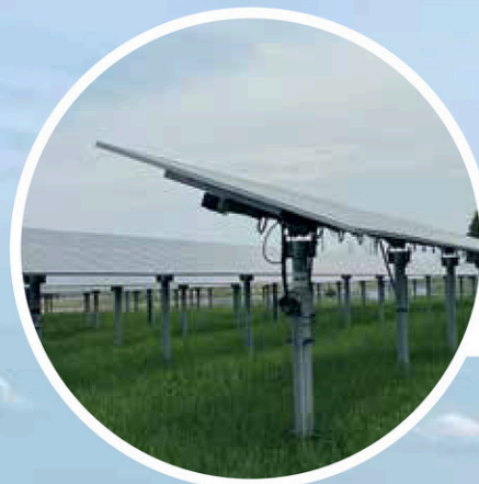
Panneaux avec suiveurs
