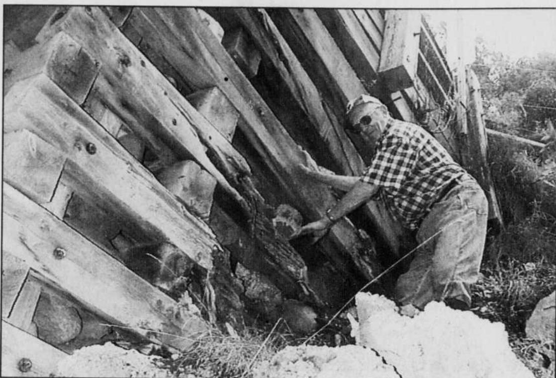
Photo La Tribune, archives Le pont qui mène à la ferme de William Murphy, à Stanstead-Est, a besoin d'être consolidé.
