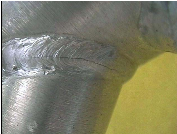
Photographie 5.7-3 Évaluation du comportement des assemblages soudés CEC 2 – Fissure affectant l'assemblage soudé d'une membrure diagonale
