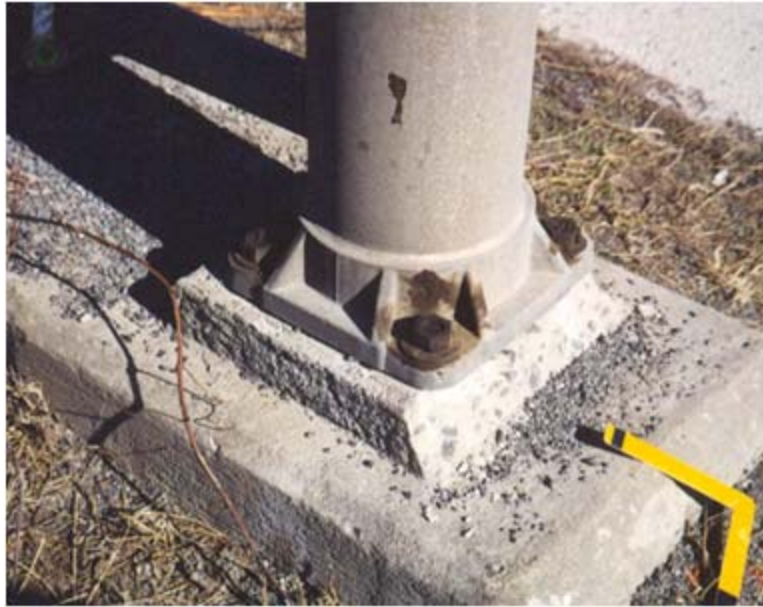
Photographie 5.4-24 Anomalie de la semelle d'ancrage Anomalie – Contact entre l'aluminium de la semelle et le béton
