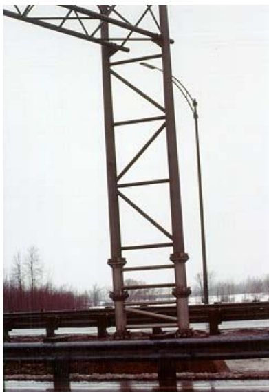
Photographie 5.5-10 Anomalie du support vertical
