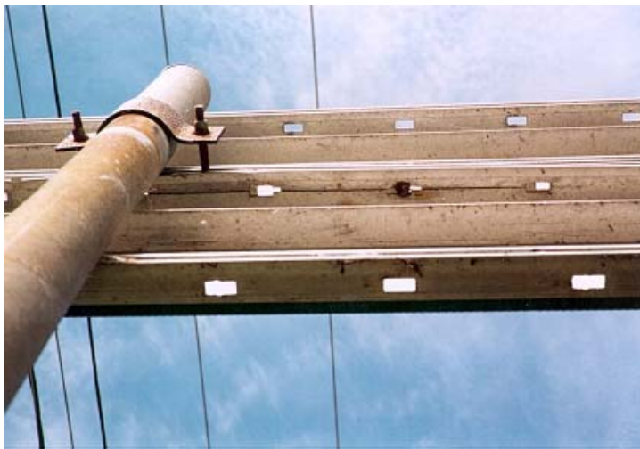
Photographie 5.10-2 Évaluation du comportement de l'extrusion CEC 2 – Rainure de l'extrusion endommagée de façon importante par le manque d'attaches
