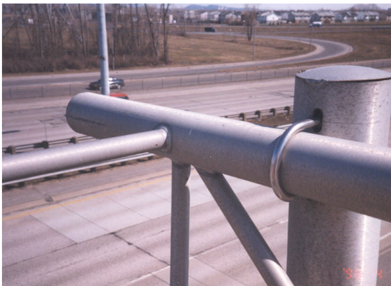
Photographie 5.6-19 Anomalie du support en treillis
