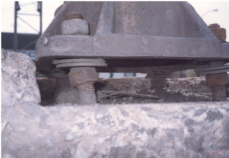
Photographie 5.4-17 Anomalie des tiges d'ancrage
