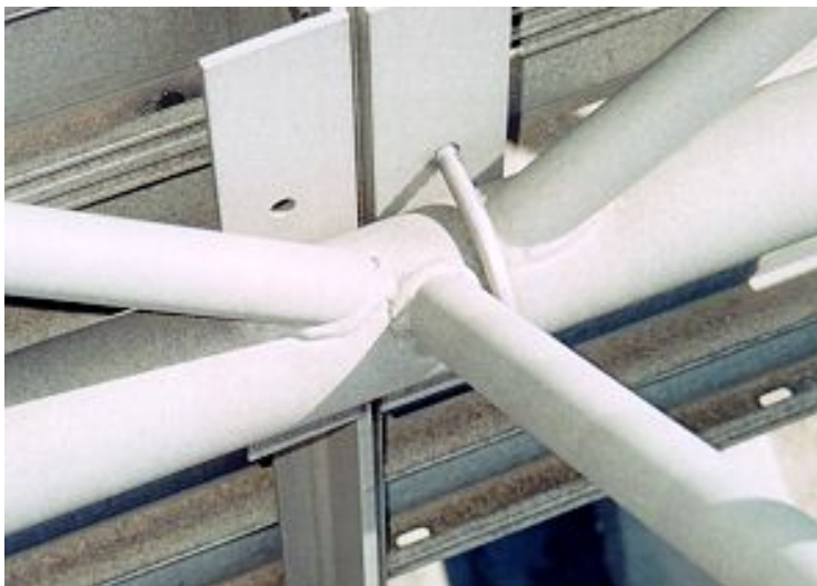
Photographie 5.10-13 Anomalie des attaches
