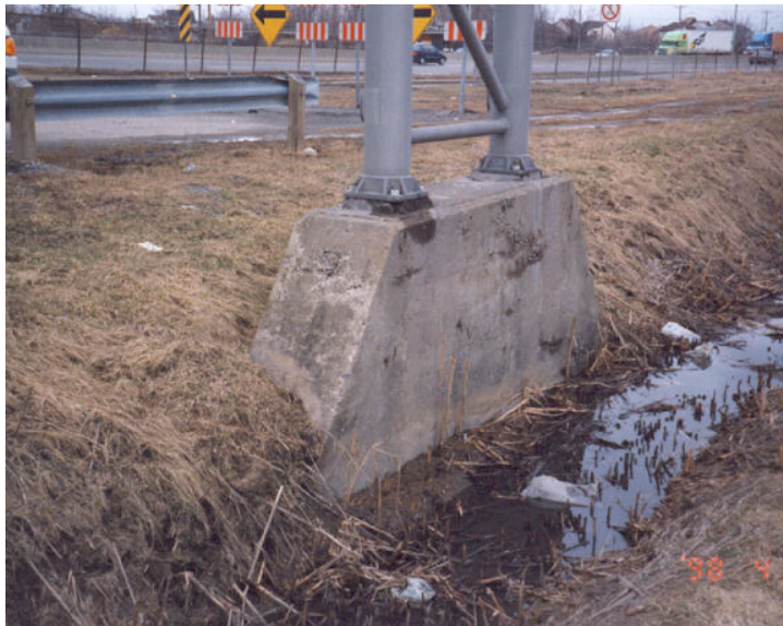
Photographie 5.3-10 Anomalie relative au remblai
