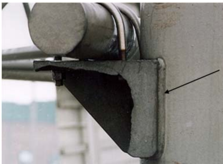
Photographie 5.7-5 Évaluation du comportement des assemblages soudés CEC 1 – Fissure affectant l'assemblage soudé d'un élément d'appui du support horizontal
