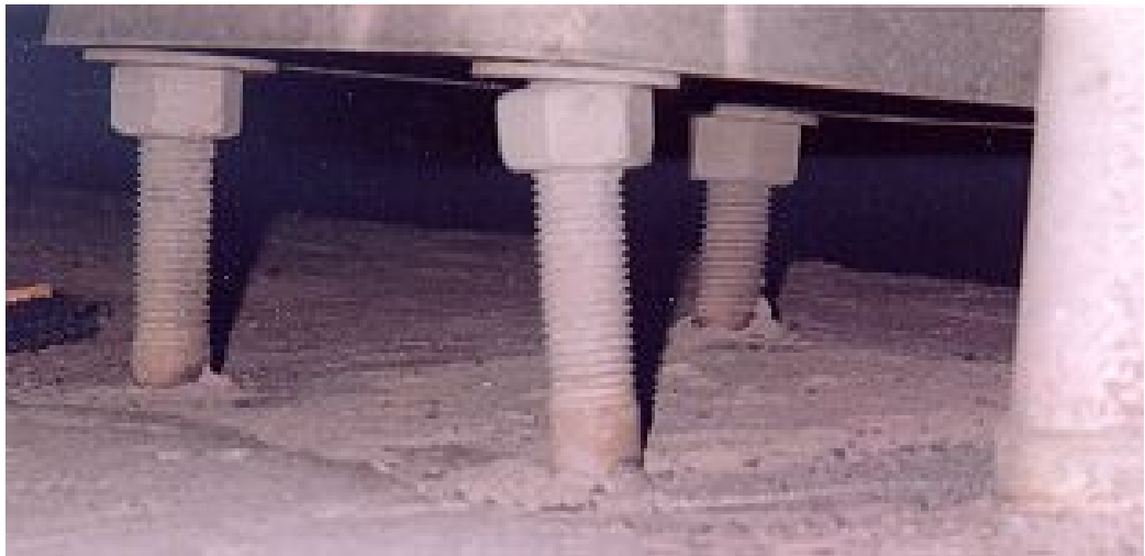
Photographie 5.4-20 Anomalie des tiges d'ancrage
