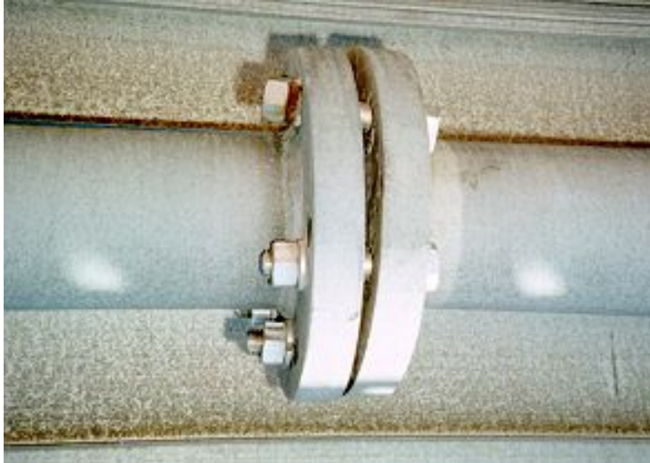
Photographie 5.8-5 Anomalie des assemblages boulonnés
