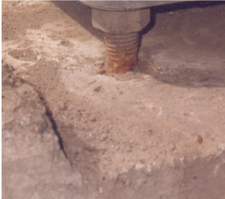
Photographie 5.4-1 Évaluation du comportement des tiges d'ancrage
