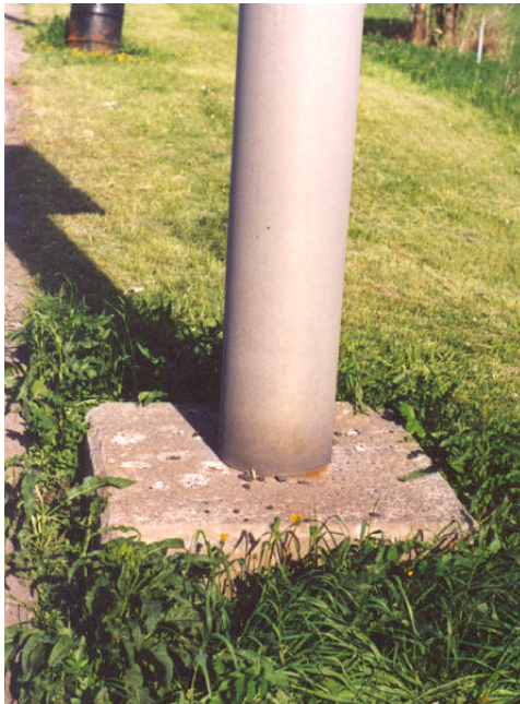
Photographie 5.4-16 Anomalie des tiges d'ancrage Anomalie – Absence de tiges et de semelle d'ancrage
