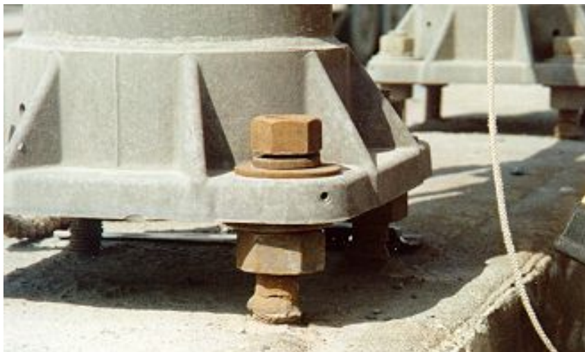
Photographie 5.4-22 Anomalie des tiges d'ancrage Anomalie – Tiges d'ancrage allongées par soudage
