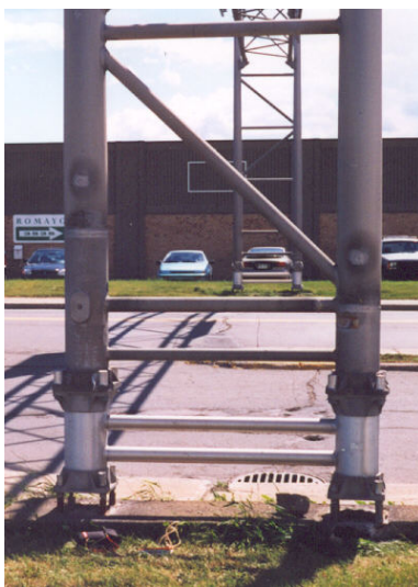
Photographie 5.5-11 Anomalie du support vertical
