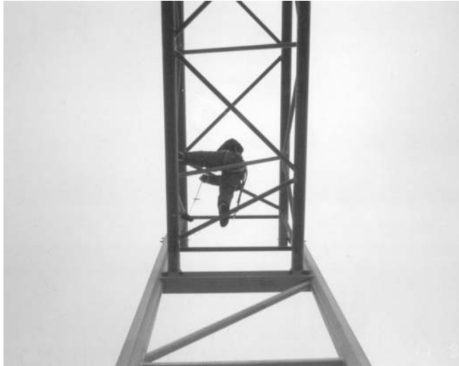
Photographie 5.6-20 Anomalie du support en treillis
