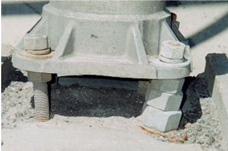
Photographie 5.4-23 Anomalie des tiges d'ancrage Anomalie – Réparation de fortune d'une tige d'ancrage
