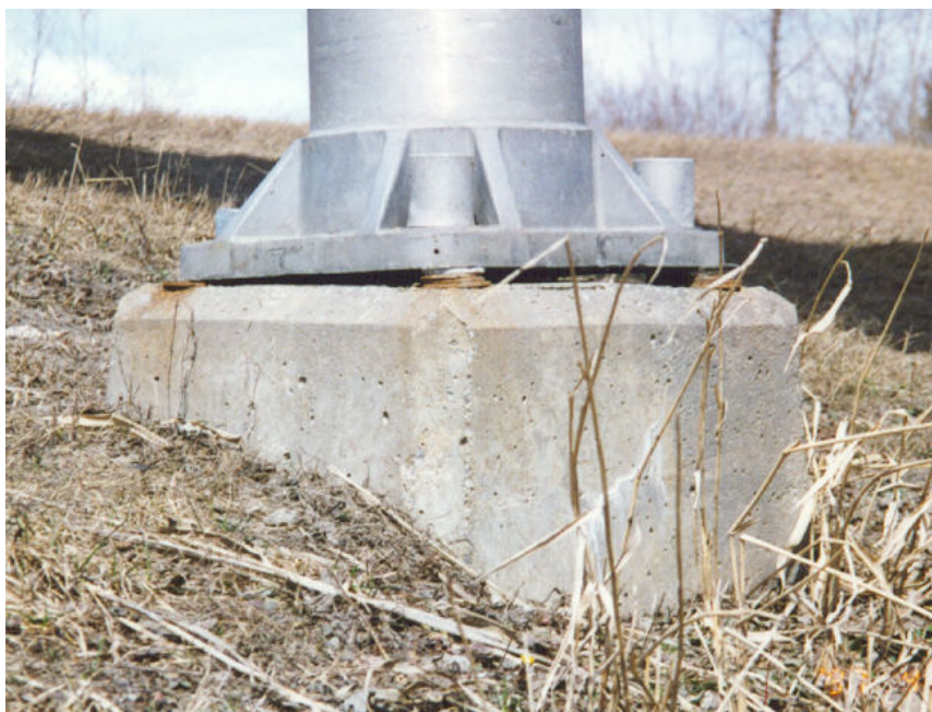
Photographie 5.4-19 Anomalie des tiges d'ancrage Anomalie – Impossibilité de serrer adéquatement les boulons
