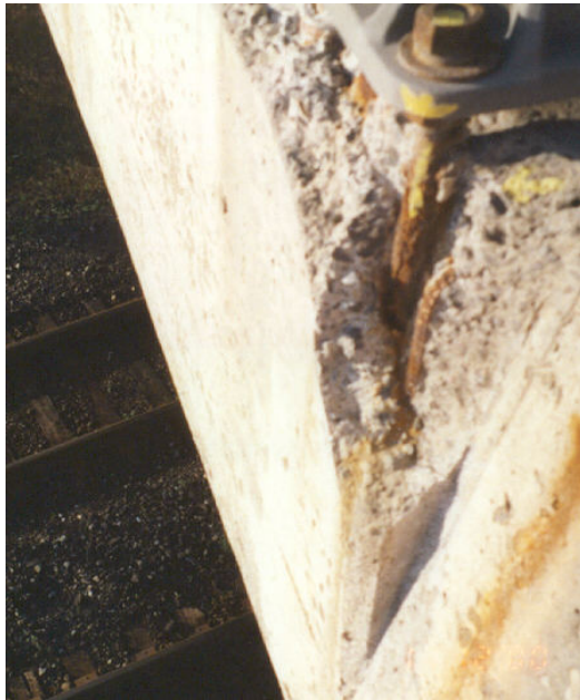
Photographie 5.4-4 Évaluation du comportement des tiges d'ancrage
