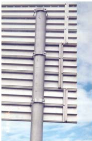
Photographie 5.10-11 Anomalie de la pièce en T
