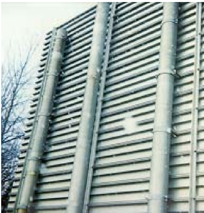
Photographie 5.10-12 Anomalie des attaches
