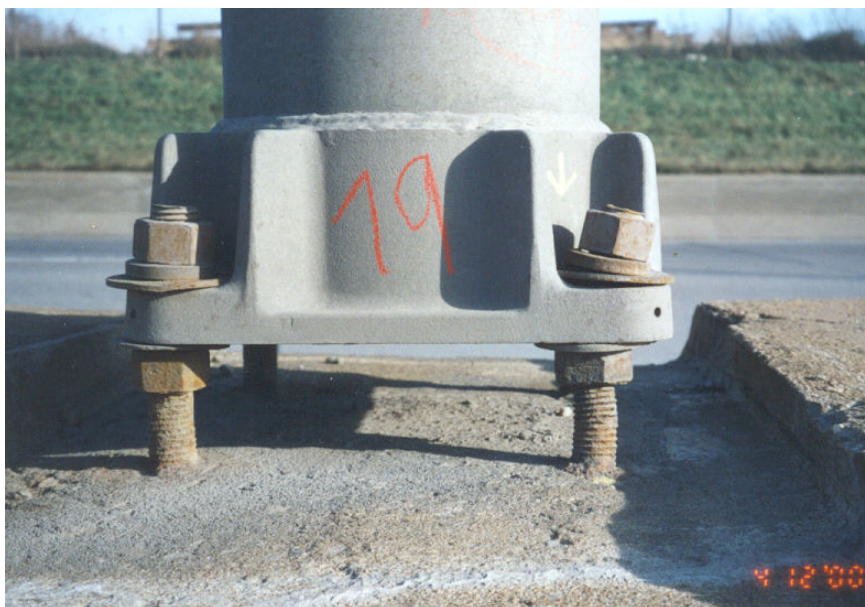
Photographie 5.4-18 Anomalie des tiges d'ancrage Anomalie – Impossibilité de serrer adéquatement les boulons
