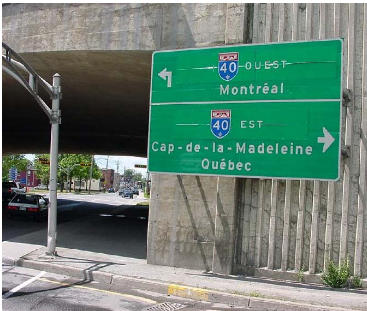
Photographie 1.4-10 – Structure de type L5
