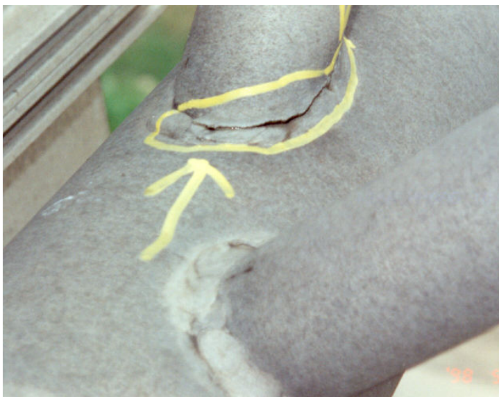
Photographie 5.7-4 Évaluation du comportement des assemblages soudés CEC 2 – Fissure affectant l'assemblage soudé d'une membrure diagonale
