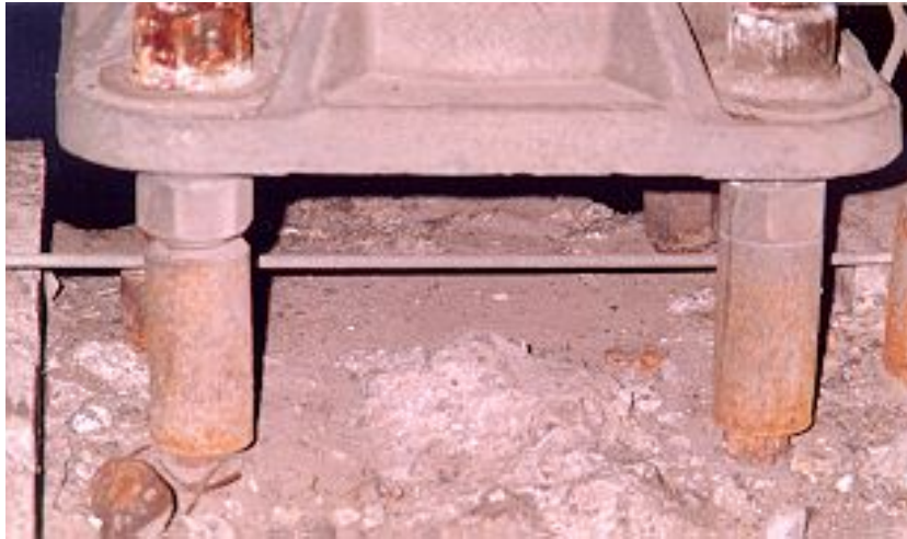
Photographie 5.4-21 Anomalie des tiges d'ancrage Anomalie – Tiges d'ancrage rallongées à l'aide d'un manchon
