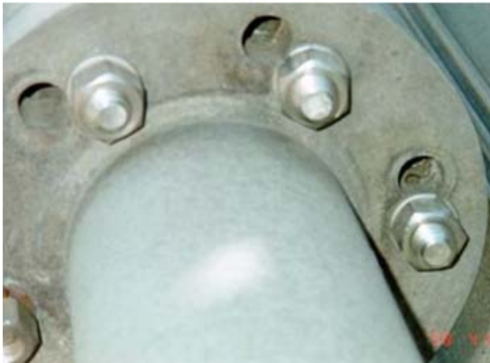
Photographie 5.8-6 Anomalie des assemblages boulonnés
