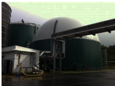
Usine de méthanisation Géotexia
