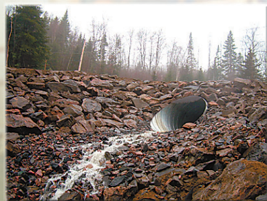
Aménagement d'un ponceau de diamètre 2700 mm, chemin Bourassa, La Tuque, à la suite des fortes pluies de mai 2006. Exécuté pour les Entreprises Carl Marchand (photo novembre 2006).
