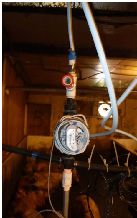
Figure 8 Photo du compteur d'eau utilisé et de son assemblage sur la ligne d'eau
