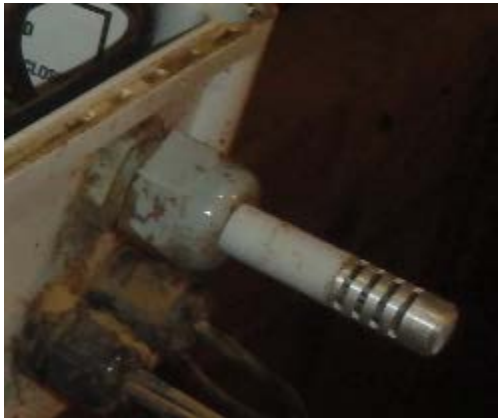
Figure 15 Photo de l'installation du capteur de température et d'humidité sur les boîtiers de contrôle
