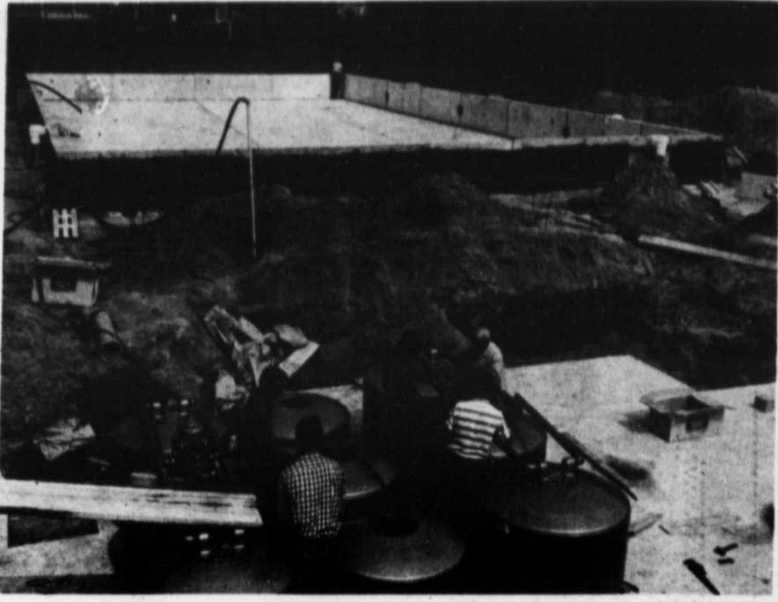
Construction de la piscine de Pierreville, située à l'arrière du Centre Culturel. (Photo A. Courchesne)
