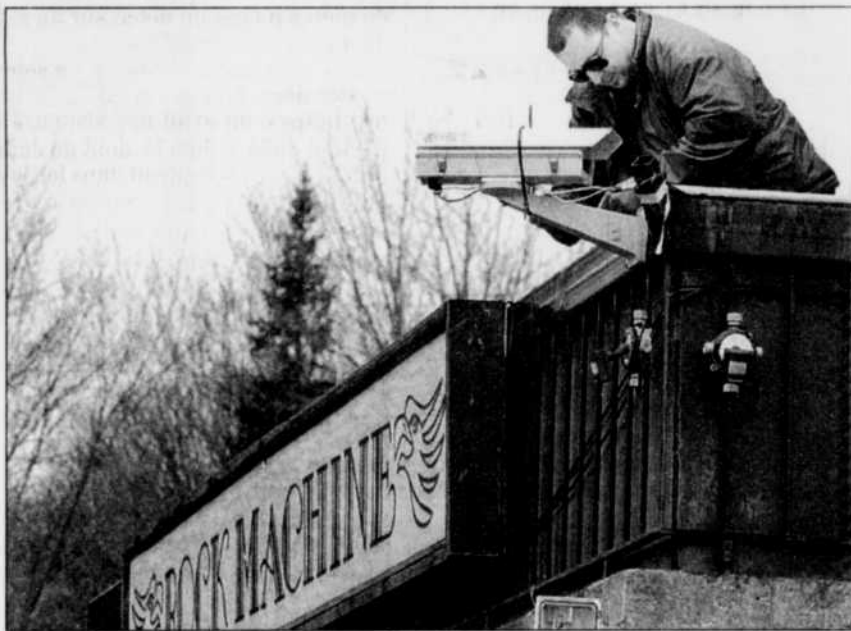
Un policier installe une caméra de surveillance au local des Rock à Beauport.
