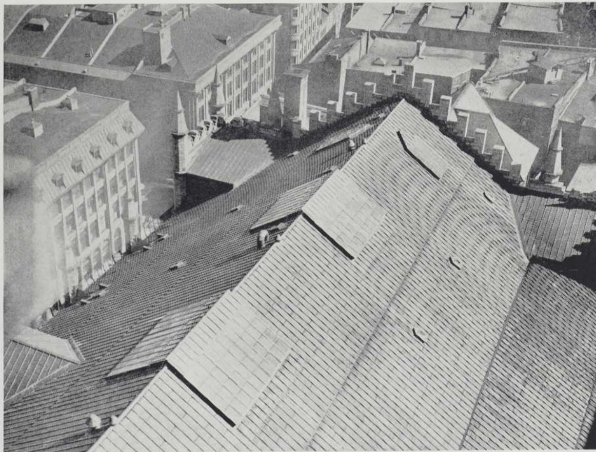
Ci-dessus, vue d'une partie de la nouvelle toiture en cuivre de l'église Notre-Dame de Montréal, exécutée par la maison Philibert Bédard Ltée.
