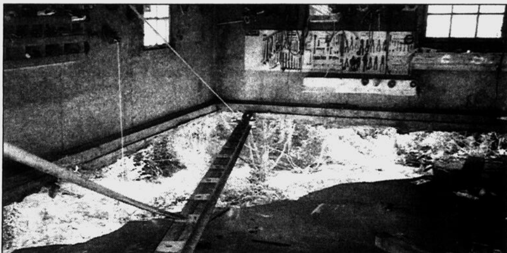
Le garage du propriétaire du Camping de la Rive, à Baie-St-Ludger, a subi de lourds dommages pendant le déluge du 20 juillet. Il s'en est fallu de peu qu'il se retrouve complètement dans le ruisseau.
