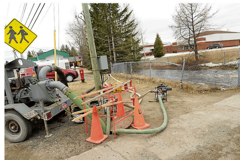
La municipalité de Labrecque a installé des pompes au coeur du village pour surverser son égout sanitaire dans la rivière Mistook. La situation a soulevé l'indignation sur les réseaux sociaux. — PHOTO LE QUOTIDIEN, GIMMY DESBIENS
