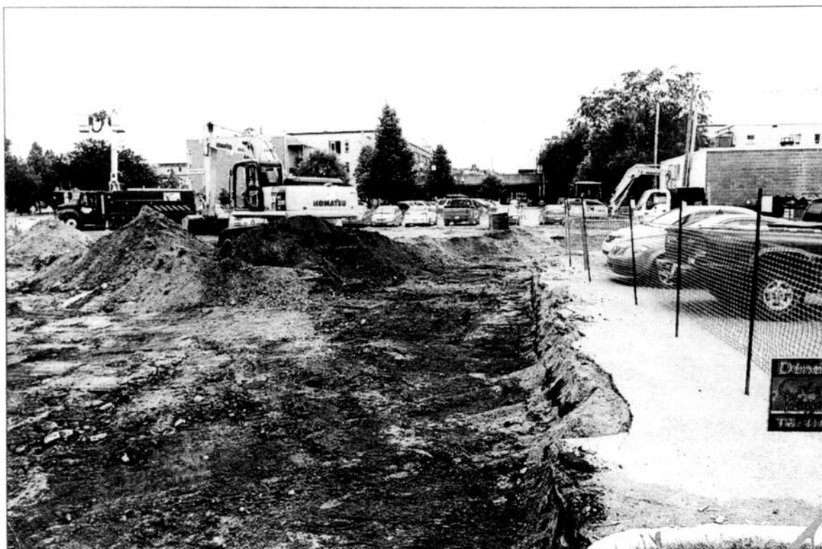
Le paysage de la rue Racine et la grogne des commerçants devraient durer jusqu'à la fin octobre, date prévue pour la fin des travaux de la Place du citoyen.
