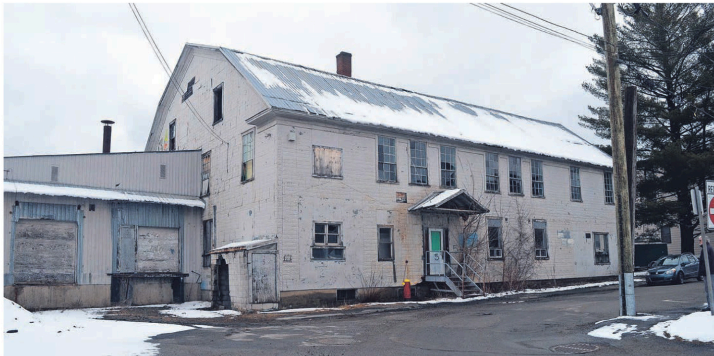
Une partie de l'ancienne usine Filtex s'est affaissée sous le poids de la neige vendredi dernier. (Photo : Journal Le Guide – archives)
