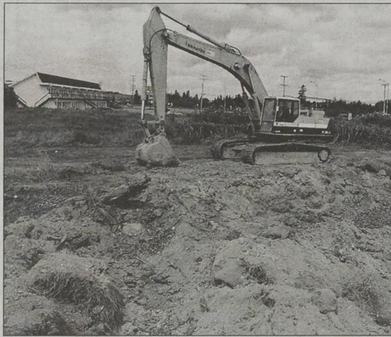
Les pelles mécaniques sont déjà arrivées sur le futur site du Quartier des Joyaux.
