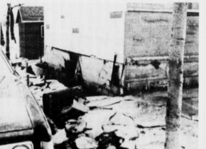
LES FONDATIONS DE CETTE MAISON de la rue Bellerive devront être refaits entièrement, entraînant des déboursés que la famille ne peut se permettre. (PHOTO "LA REVUE" GILLES CHAPUT)
