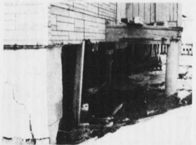
UNE PARTIE DES FONDATIONS de la maison de M. et Mme Jean-Paul Quevillon, au 151, rue Léon-Martel, à Terrebonne. Des dommages considérables qui commanderont des investissements très importants. (PHOTO "LA REVUE" GILLES CHAPUT)
