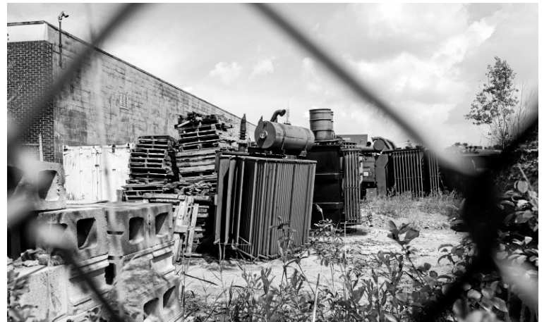
Des transformateurs sont entreposés illégalement par Reliance.
