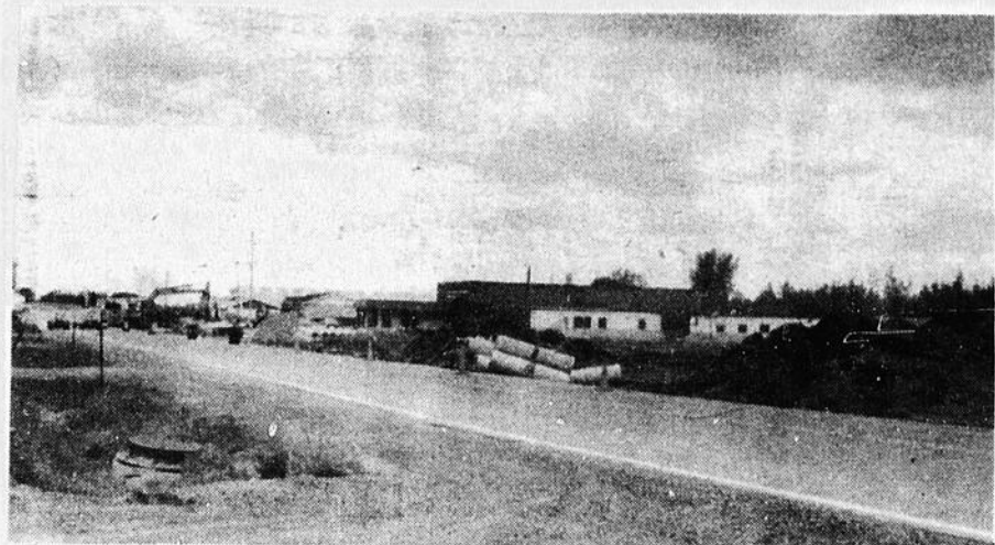
Les travaux visant à transformer une partie de la route 158 en boulevard urbain ont pris leur envol, la semaine dernière. Pour les semaines à venir, la circulation sur la route 158, à Berthierville, sera perturbée par ces travaux d'importance.
