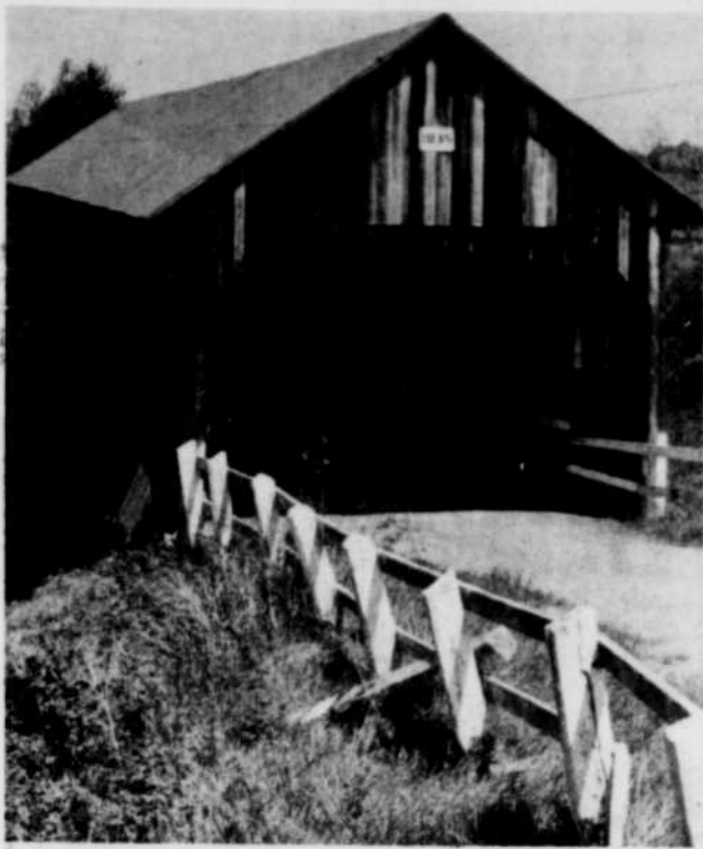
Certains ponts couverts, comme celui-ci qui se trouve près de Cookshire, défient le temps et les éléments depuis près de 150 ans.
