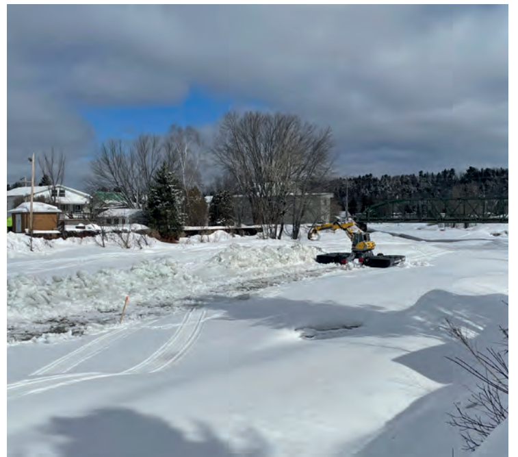
La pelle-araignée a creusé un chenal sur deux kilomètres afin de faciliter l'écoulement de l'eau ainsi que le passage des glaces. Photo - Stéphane Pelletier
