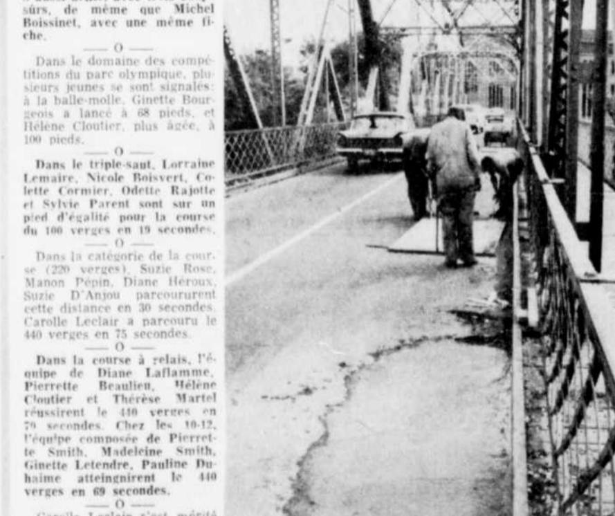
CE VIEUX PONT ! — Des réparations ont encore été effectuées pour la 10e fois cette semaine, à l'indéfectible vieux pont de la rivière St-François, près de la Centrale électrique de la Southern. Tout ce en attendant que le nouveau pont soit construit et que celui-ci soit encore réparé ! (Photo La Tribune, Drummondville)
