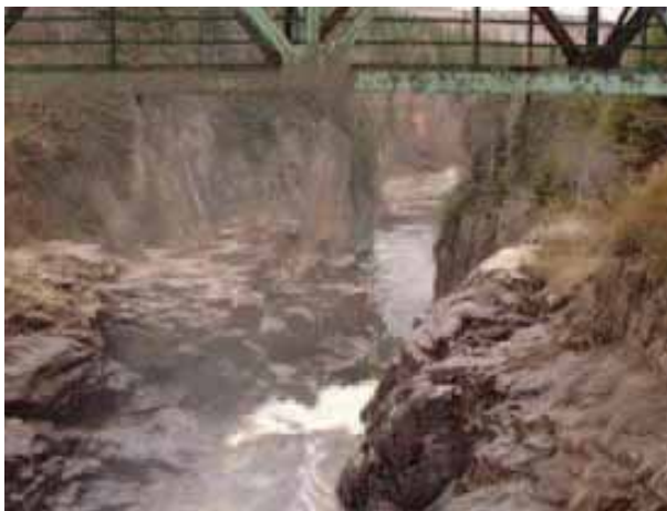
Figure 21 Chute près de la route 138 : barrière infranchissable pour le saumon atlantique sur la rivière aux Anglais (Source : Fédération québécoise pour le saumon atlantique)
