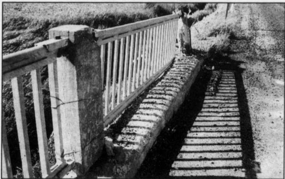
L'état du pont sur le 3 e rang des Moulins Est est si délabré que la municipalité de Saint-Denis-sur-Richelieu envisage de le fermer à la circulation.
