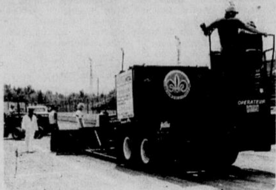
La nouvelle machine de transfert faisait partie de l'équipement qui n'a pas servi à Sherbrooke. (Photo Le Soleil)
