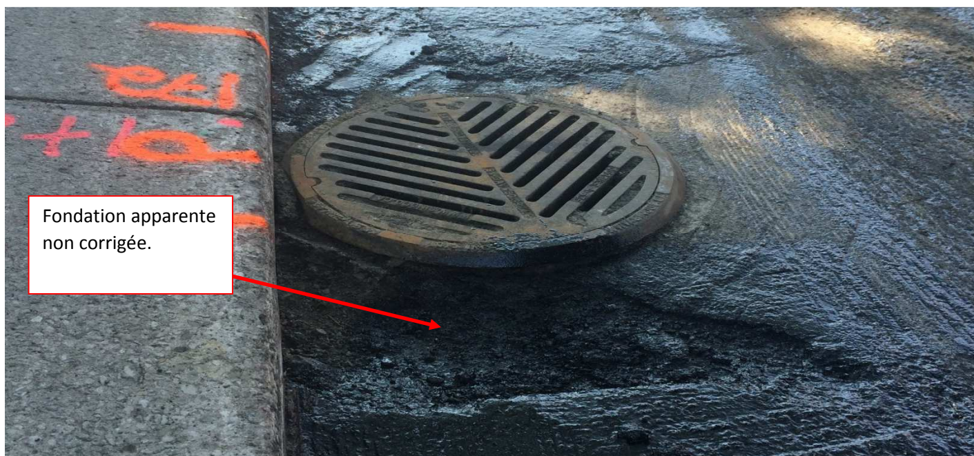
- Photo # 5 prise par le Bureau de l'inspecteur général le 17 septembre 2015 sur la rue Monselet et illustrant un défaut non corrigé qui atteint la fondation.
