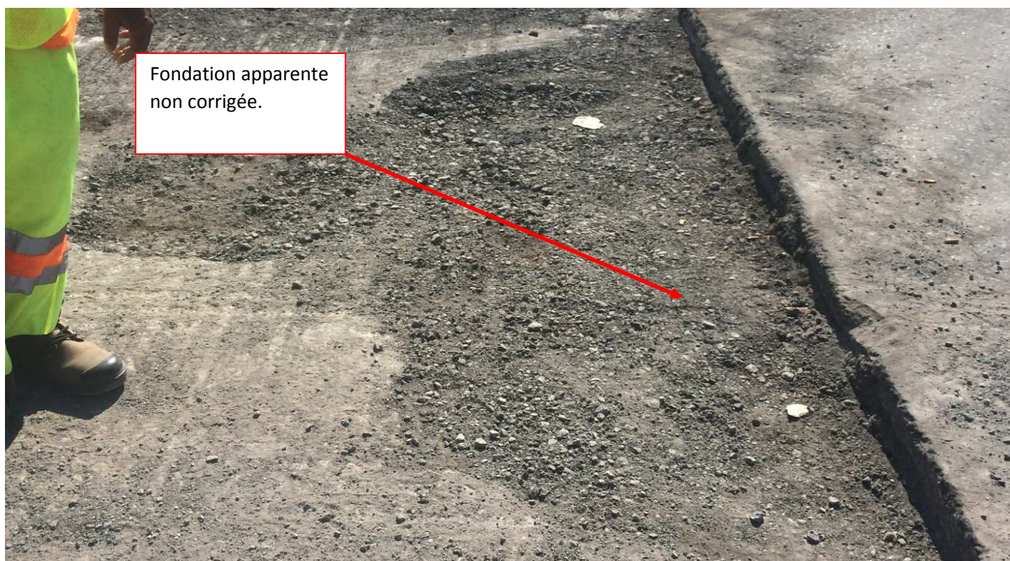
- Photo # 6 prise par le Bureau de l'inspecteur général le 17 septembre 2015 sur la rue Monselet et illustrant un défaut non corrigé qui atteint la fondation.
