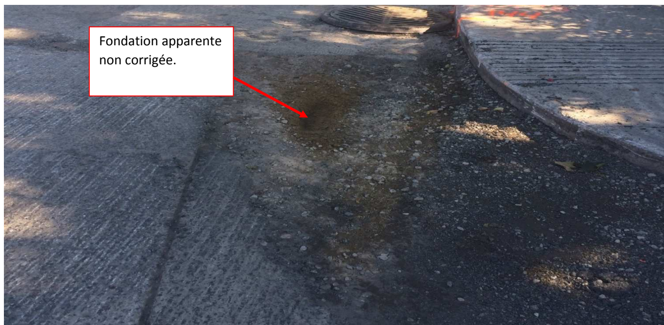
- Photo # 3 prise par le Bureau de l'inspecteur général le 17 septembre 2015 sur la rue Monselet et illustrant un défaut non corrigé qui atteint la fondation.
