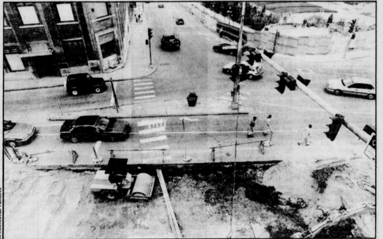
Les travaux en face de l'édifice du SOLEIL, devraient être terminés le 3 août.
