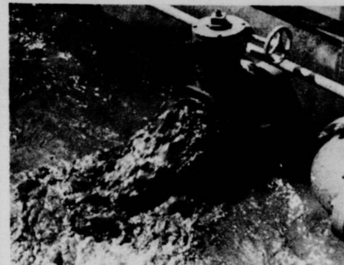
Dans un bassin d'aération de McKaye, l'arrivée des boues activées.
