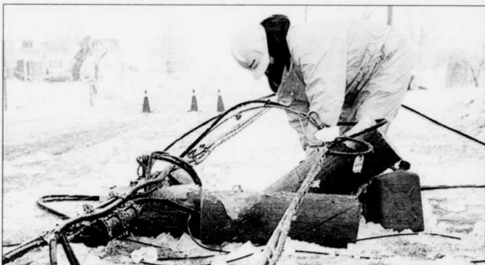
C'est par milliers que les poteaux d'électricité qui servent à alimenter les abonnés, ont cédé sous le poids de la glace. Leur remplacement a été un des principaux défis des équipes d'Hydro-Québec et de leurs collègues venus d'aussi loin que du Michigan pour leur prêter main-forte.
