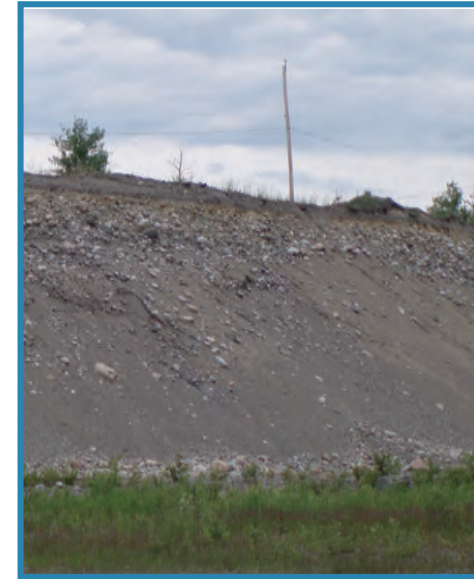
Photo 1b – Site 214 en 2019. Les faces sont effondrées et en végétation.
