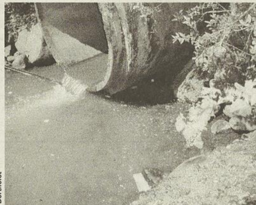
Pas réjouissante la qualité de l'eau qui est rejetée directement dans la rivière Du Nord à quelques pas de l'usine de traitement des eaux usées de Ste-Agathe-Des-Monts.
