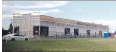
Les premiers bâtiments s'élèvent actuellement sur le site du Carrefour de la Bravoure.
