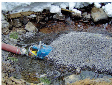
Pompe installée dans un matériau filtrant
