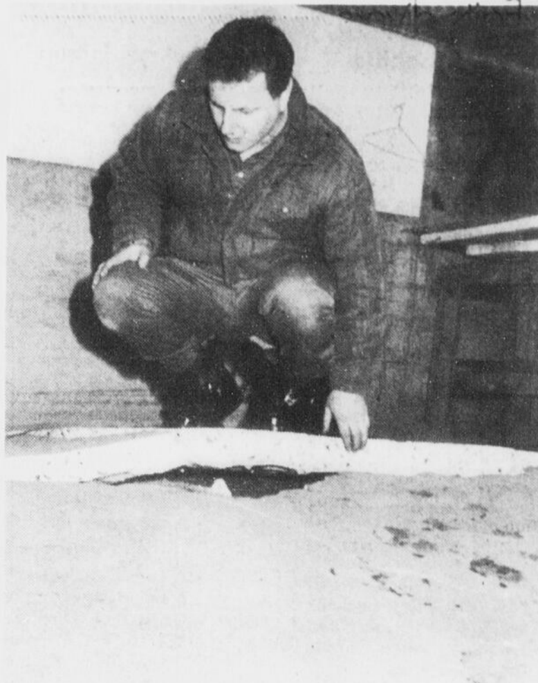
PLANCHER — Denis Laberge ne peut que constater les bris qu'aura causés le tremblement de terre à La Baie. Ici, le plancher du sous-sol d'un édifice à logements de l'Office municipal d'habitation a été soulevé de trois pieds.
