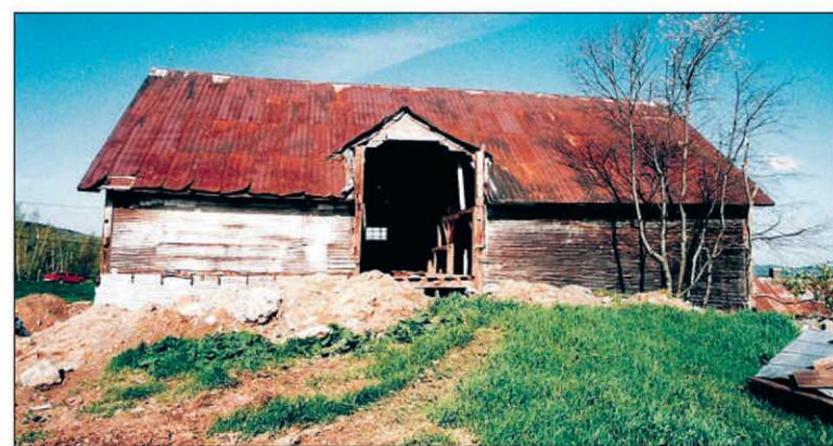
Avant la restauration, la grange était au bord de l'effondrement.
