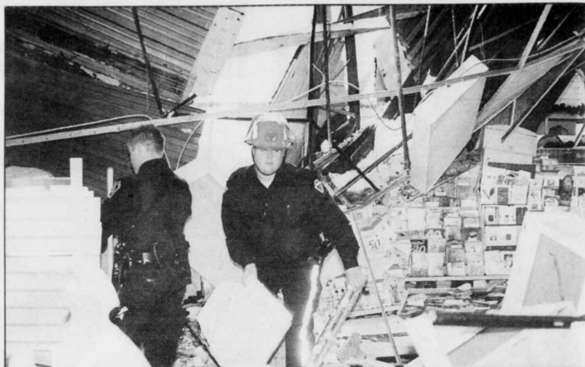
Une accumulation de neige sur le toit plat du centre commercial, construit il y a 30 ans, serait responsable de l'effondrement d'une section de 21 mètres de long et de 15 mètres de large. Les policiers n'ont pas trouvé d'autres victimes
