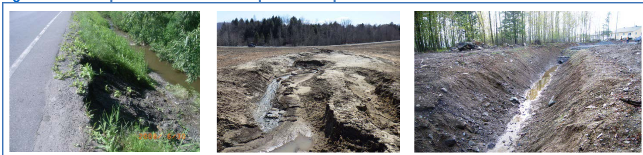
Figure 19 – Exemples d'observations de problématiques d'érosion
