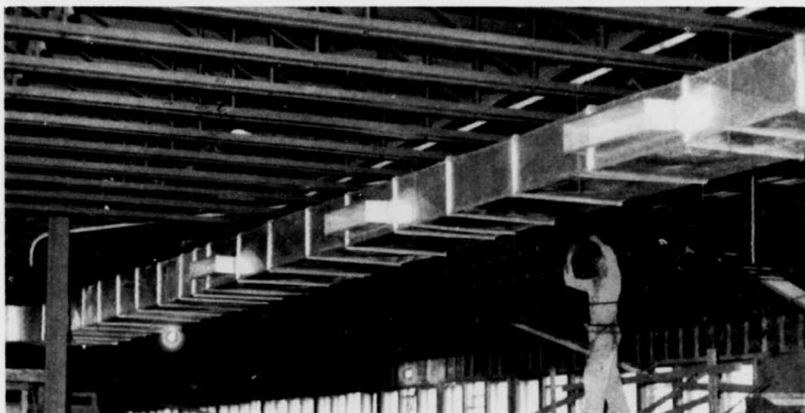
Vue partielle d'un système de ventilation au laboratoire de Physique et Chimie de l'Université d'Ottawa faite par
