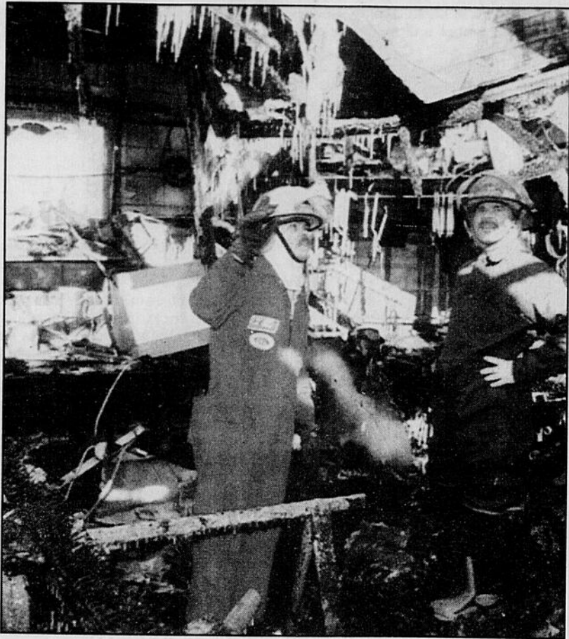
Le lieutenant-inspecteur Michel Richer et l'inspecteur Gilles Pelland, du Département de prévention des incendies de Sherbrooke, ont effectué des recherches approfondies, hier, dans l'atelier de soudure incendié.
