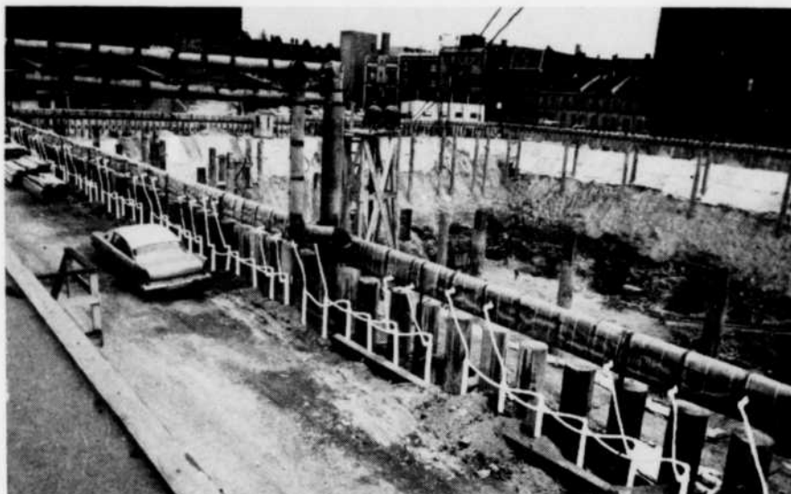
Vue d'ensemble du réseau de tuyauterie qui effectuait la congélation du sol et maintenait la température du sous-sol entre 6 et 30° F.
