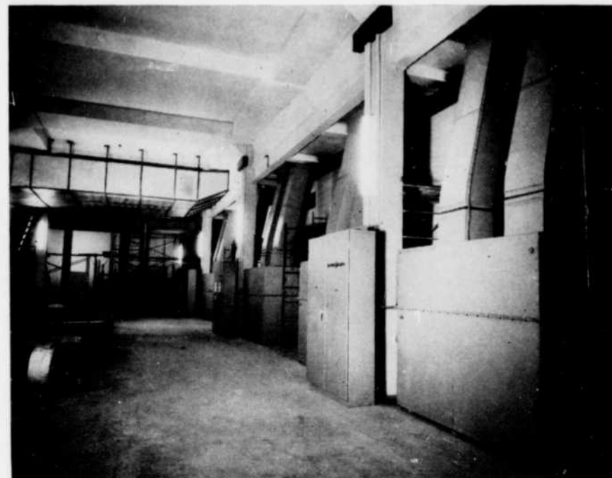
Refroidisseurs à air installés près des salles de transformateurs.
