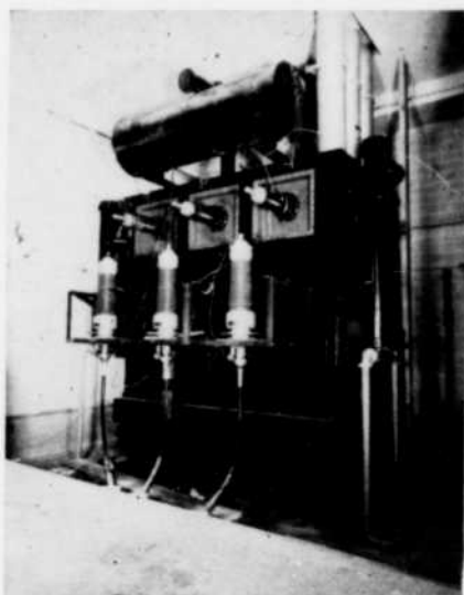
Un des six transformateurs principaux de 40,000 KVA.
