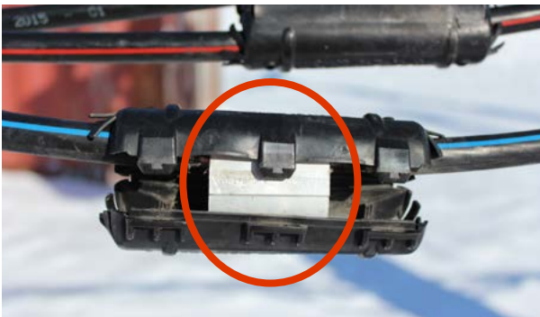
Protecteur ouvert ou endommagé
