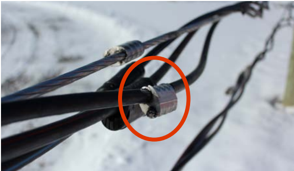
Protecteur manquant sur la connexion
