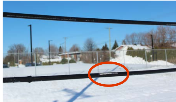
Gaine de conducteur endommagée
