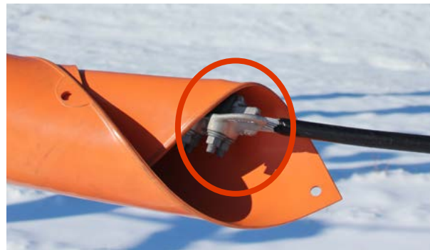
Partie de conducteur laissée à nu par le protecteur
