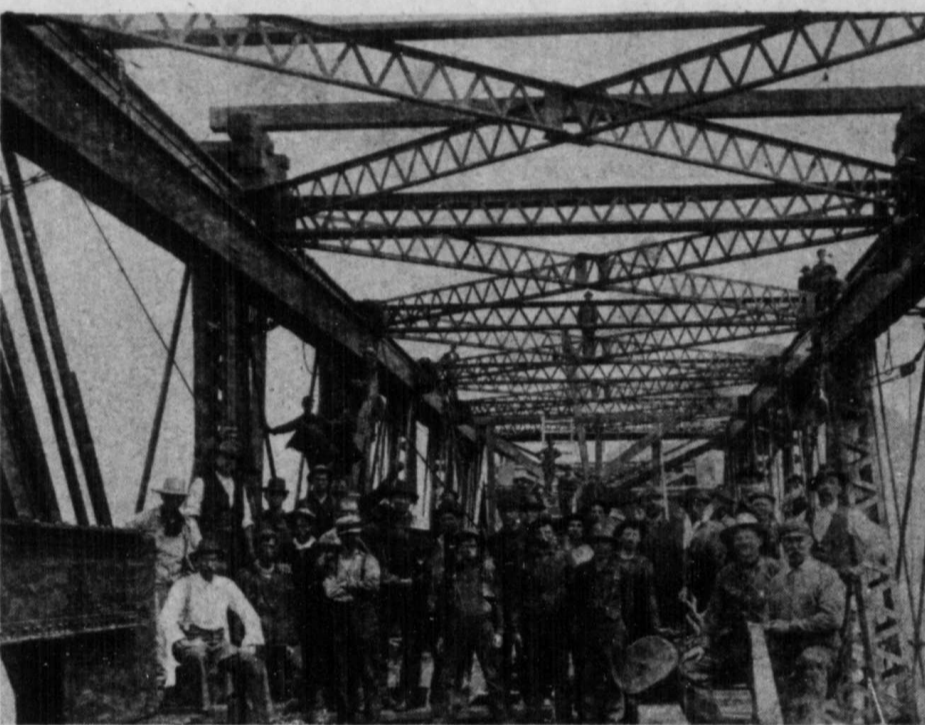
PHOTO DU BAS: Equipe d'ouvriers de Longueuil, de St-Lambert et des environs qui participèrent à la reconstruction du Pont Victoria en 1898-1901. On y ajouta une deuxième voie ferrée, deux voies carrossables et deux trottoirs à la structure déjà existante en renforçant les piliers. Ces travaux de rénovations coûtèrent $2,000,000.00. ARCHIVES: Musée historique d'électricité de Longueuil.
