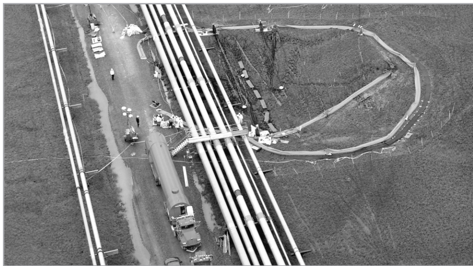
La découverte d'une fuite sur l'oléoduc de la compagnie BP qui alimente les États-Unis avec 400 000 barils par jour nécessite le remplacement de 25 km de tuyaux ainsi que l'interruption de la production pendant plusieurs semaines, voire plusieurs mois.
